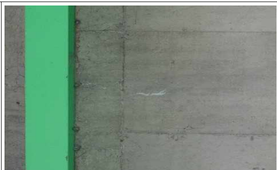
바닥판하면 상행선 S7 균열부 백태
