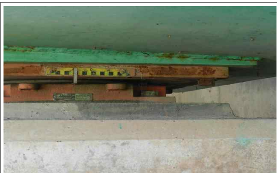
교량받침 하행선 A1 SH1 상부플레이트 녹발생
