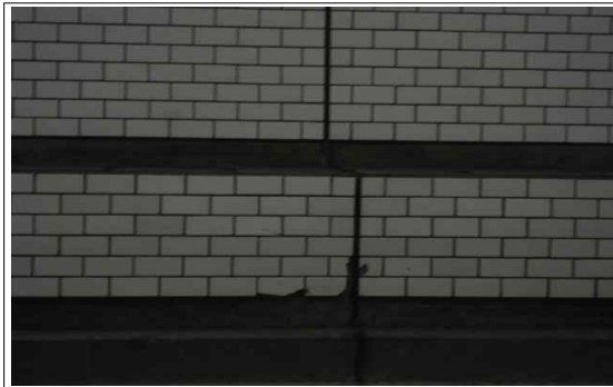
하행선 공동구 S46 측면 타일파손
