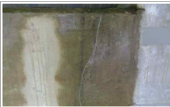
교대 상행선 A1 구체 수직균열(CW=0.1mm)
