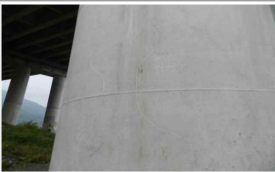
교각 상행선 P4 기둥부 수직균열(CW=0.1mm)
