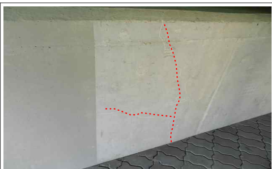
교대 상행선 A1 구체 수직, 수평균열 (CW=0.1mm)
