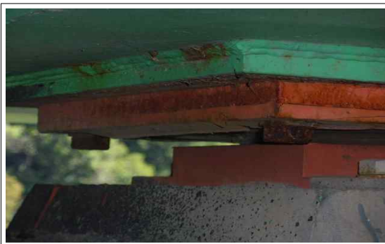
교량받침 상행선 P7 SH2 플레이트 볼트 녹발생
