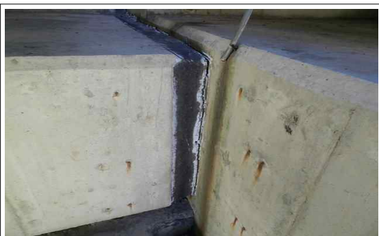
교대 상행선 A1 구체 실란트 파손
