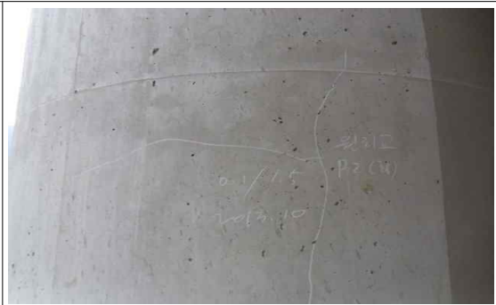
교각 하행선 P2 기둥부 수직, 수평균열 (CW=0.1mm)
