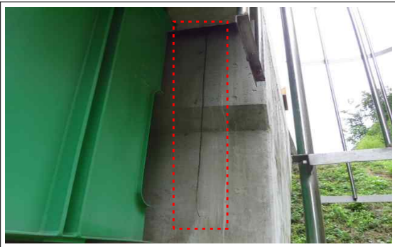
배수시설 상행선 S7(A2) 유도배수관 길이부족
