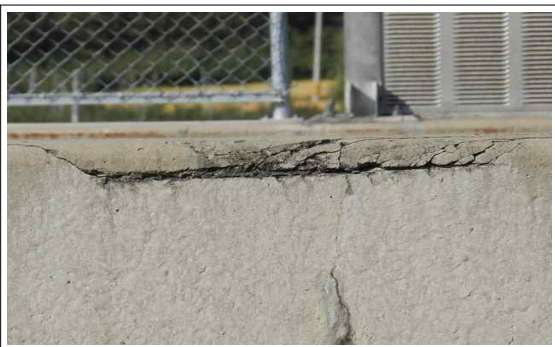
중분대 상행선 S3 콘크리트 파손
