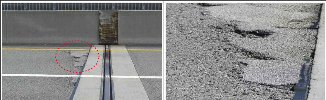
교면포장 하행선 S1 아스콘 보수부 재패임
