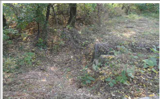
사면(시점부-우측) STA.58+ 670 산마루측구 미설치 경계부
