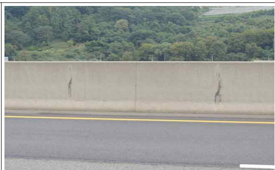
중분대 하행선 S4 균열부 백태
