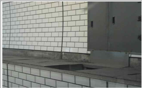
하행선 공동구 S143 덮개탈락
