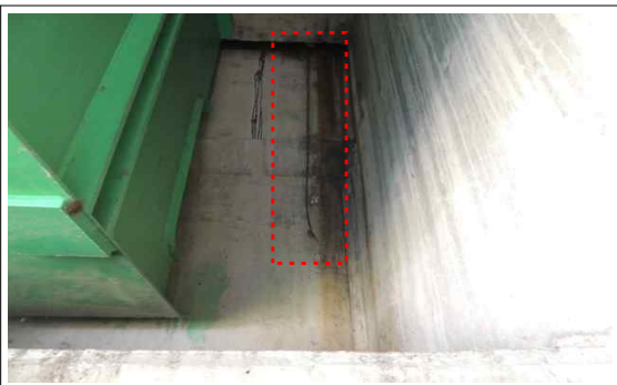
배수시설 하행선 S2(A2) 유도배수관 길이부족
