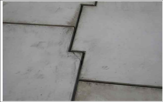
보강토 조립식 옹벽 S4 판넬 파손 (A=0.1X0.1)
