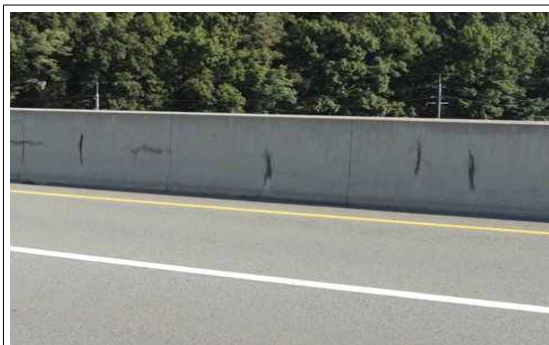
중분대 하행선 S5 균열부 백태
