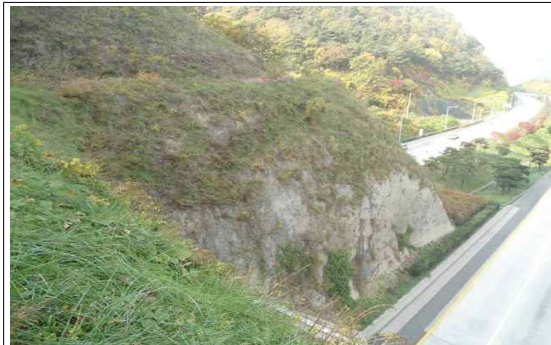
사면(중점부-정면) STA.0-5 1단 녹생토유실
