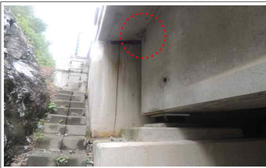
배수시설 상행선 S1(A1) 유도배수관 길이부족
