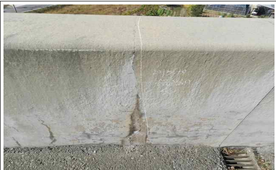
방호벽 하행선 S6 수직균열(CW=0.3mm)
