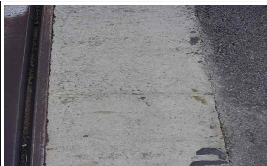
신축이음 상행선 Exp.J6(A2) 후타재 균열 (CW=0.2mm)
