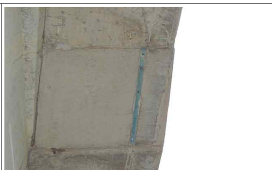
바닥판하면 하행선 S4 물끊기홈 미제거
