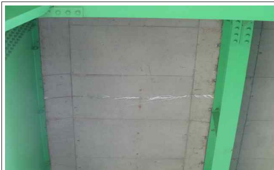
바닥판하면 상행선 S1 균열부 백태
