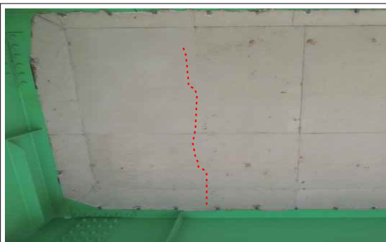
바닥판하면 하행선 S13 횡방향 균열 (CW=0.1mm)
