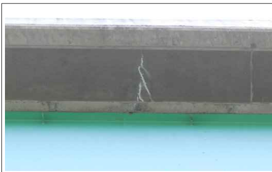
바닥판하면 하행선 S1 균열부 백태
