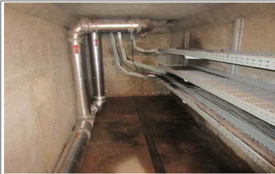
공동구내부 A면 천정부 연결홀 누수 및 체수 (STA.0+0)
