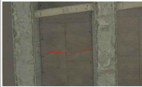
바닥판하면 상행선 S5 횡방향 균열(CW=0.1mm)
