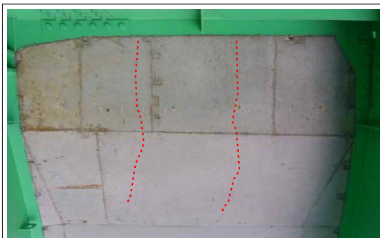
바닥판하면 하행선 S16 종방향 균열 (CW=0.2mm)
