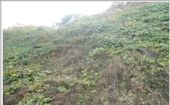
사면(중점부-정면) STA.0-10 2단 녹생토유실
