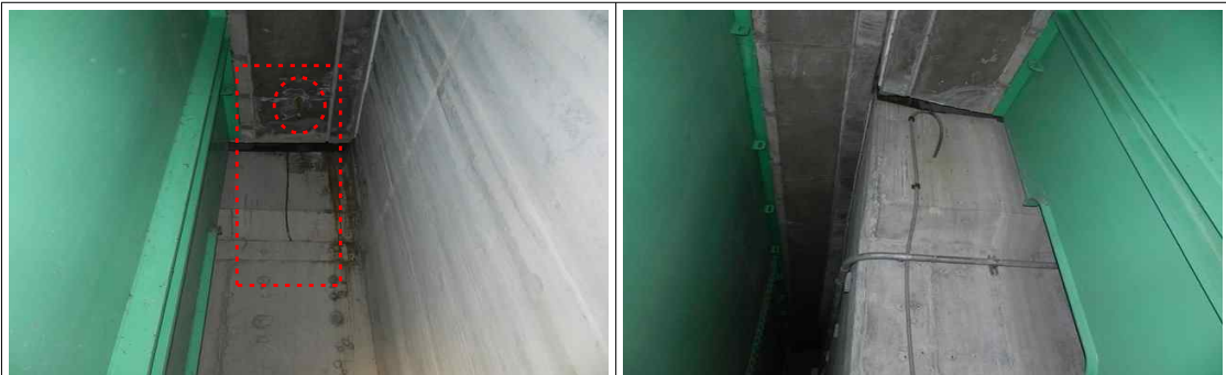
배수시설 상행선 S1(A1) 유도배수관 길이부족
