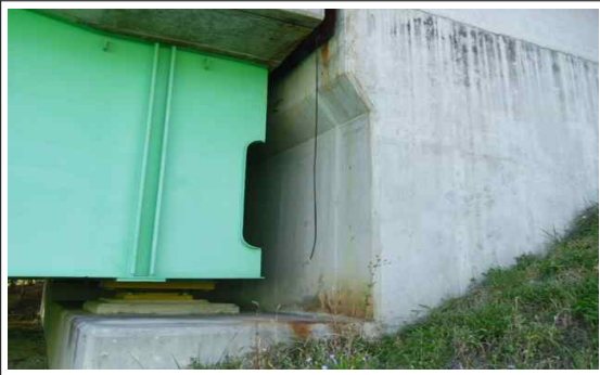
배수시설 하행선 S11(A2) 유도배수관 길이부족
