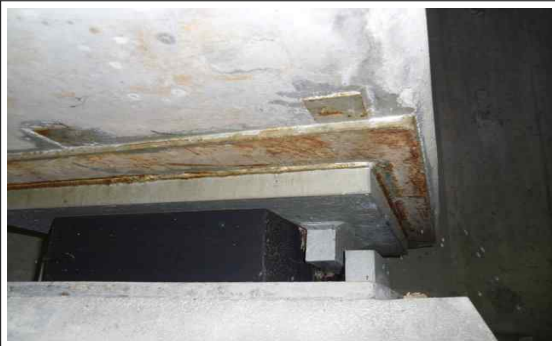
교량받침 상행선 A1 SH4 상부플레이트 녹발생
