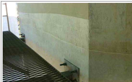
교각 하행선 P6 코핑부 수평균열(CW=0.1mm)
