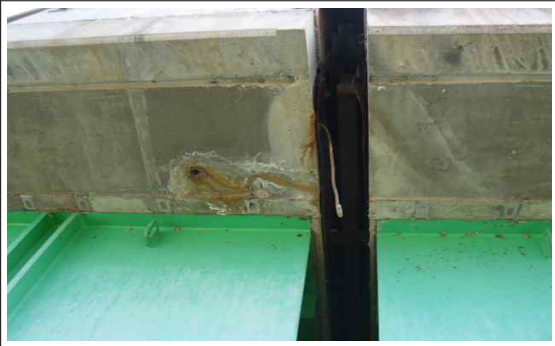
배수시설 하행선 S4(P3) 유도배수관 길이부족
