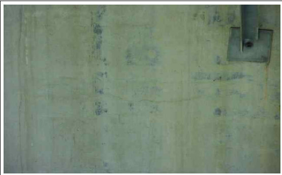
교각 상행선 P11 코핑부 수평균열(CW=0.3mm)
