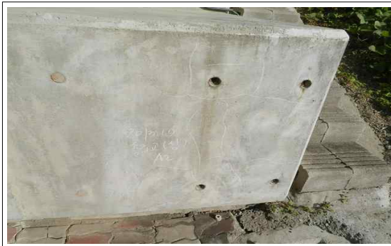
교대 상행선 A2 구체 망상균열
