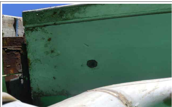
배수시설 하행선 S15(P15) 유도배수관 길이부족
