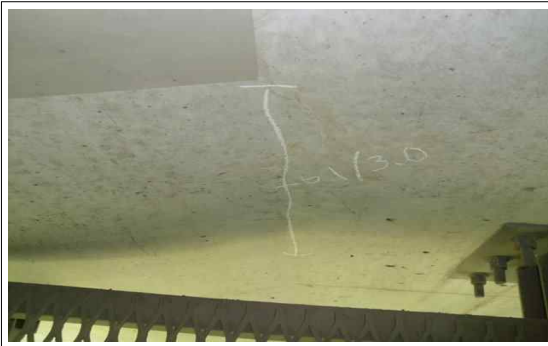
교각 상행선 P5 코핑부 수직균열(CW=0.1mm)
