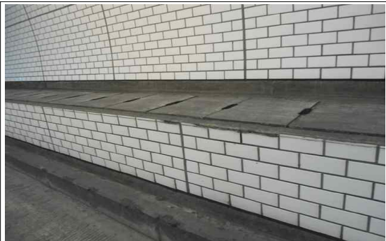
상행선 공동구 S12 측면 타일 파손
