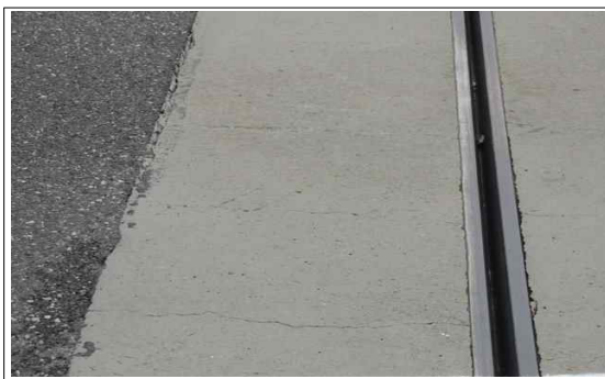
신축이음 상행선 Exp.J2(P3) 후타재 균열 (CW=0.2mm)
