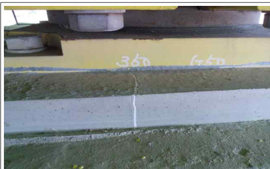
교량받침 하행선 P7 SH2 무수축물탈 균열 (CW=0.1mm)
