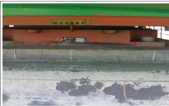
교량받침 하행선 P1 SH1 무수축물탈 균열 (CW=0.1mm)
