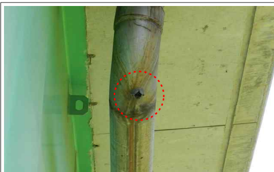
배수시설 상행선 S12 배수관 파손
