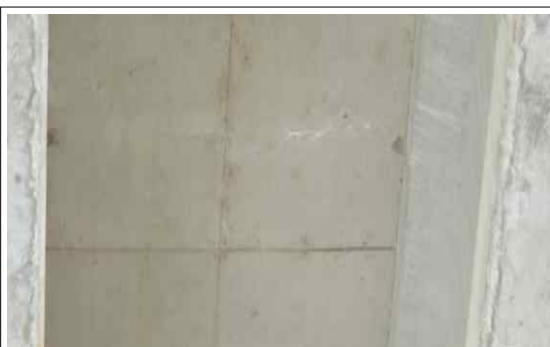
바닥판하면 하행선 S3 균열부 백태
