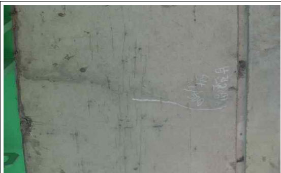
바닥판하면 상행선 S4 캔틸레버 균열 (CW=0.1mm)
