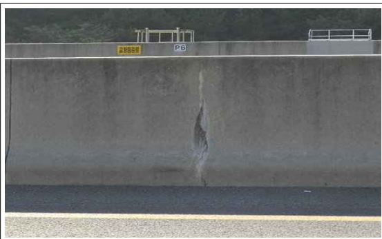
방호벽 상행선 S6 균열부 백태
