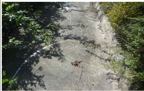
1소단배수로 균열 (71.60K 지점)
