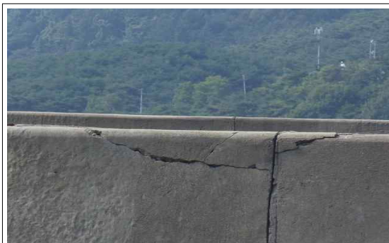
중분대 상행선 S7 콘크리트 파손
