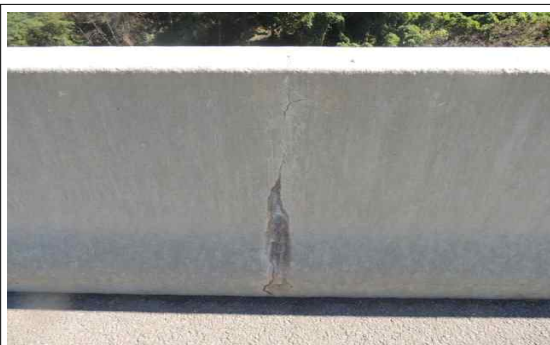
방호벽 상행선 S12 균열부 백태
