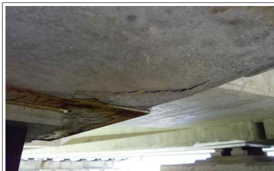
주형 상행선 S8 G4 플레이트매립부 콘크리트 파손
