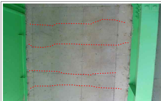
바닥판하면 하행선 S6 횡방향 균열 (CW=0.2mm)
