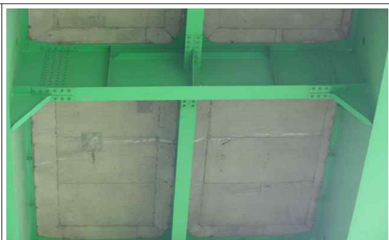
바닥판하면 하행선 S6 균열부 백태
