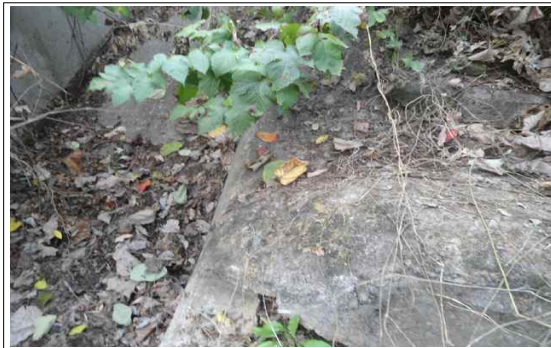
사면(중점부-정면) STA.0-30 1소단배수로 파손
