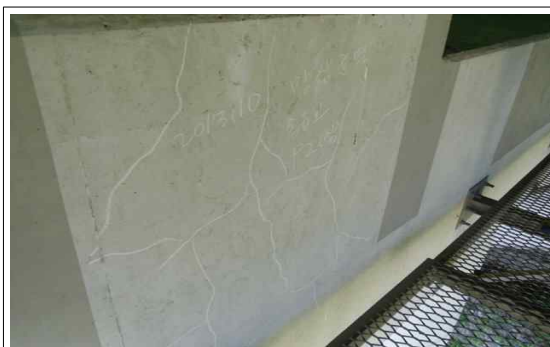
교각 상행선 P2 코핑부 망상균열
