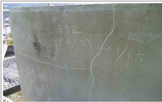
교각 하행선 P4 코핑부 수직, 수평균열 (CW=0.1mm)
