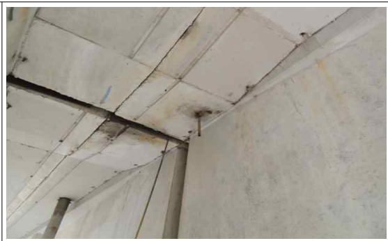
배수시설 하행선 S7(P6) 유도배수관 길이부족
