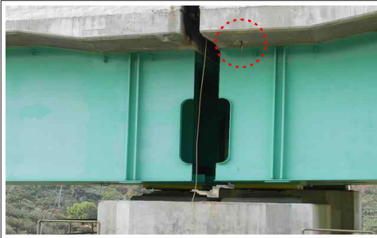
배수시설 하행선 S8(P7) 유도배수관 길이부족
