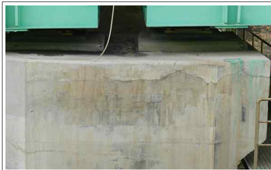
교각 하행선 P4 코핑부 콘크리트 박리
