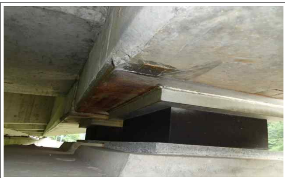
교량받침 상행선 P4 SH1 상부플레이트 녹발생
