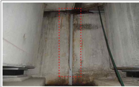
배수시설 하행선 S1(A1) 유도배수관 길이부족
