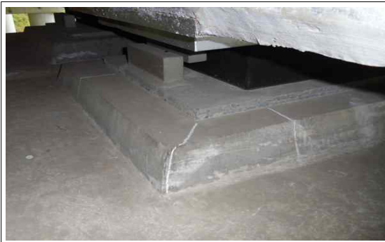
교량받침 하행선 P4 SH10 무수축물탈 균열 (CW=0.1mm)
