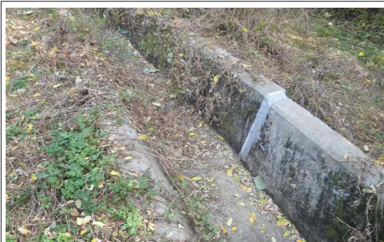
사면(시점부-우측) STA.58+ 670 산마루측구 단차
