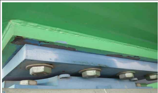
교량받침 하행선 P5 SH2 상부플레이트 도장손상
