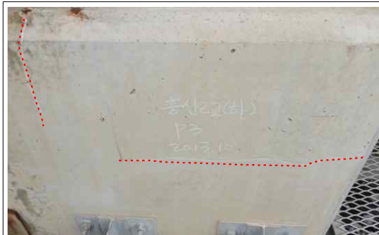
교각 하행선 P3 코핑부 수직, 수평균열 (CW=0.2mm)
