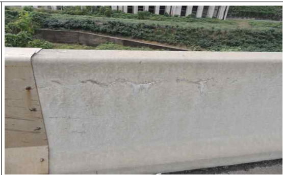
방호벽 하행선 S1 균열부 백태
