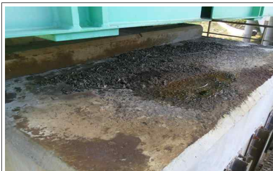
교각 하행선 P3 코핑부 콘크리트 박리, 박락
