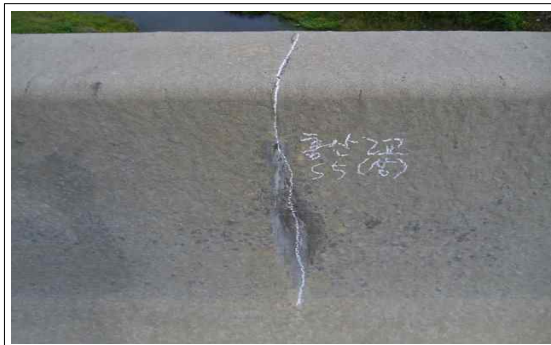
방호벽 상행선 S5 균열부 백태
