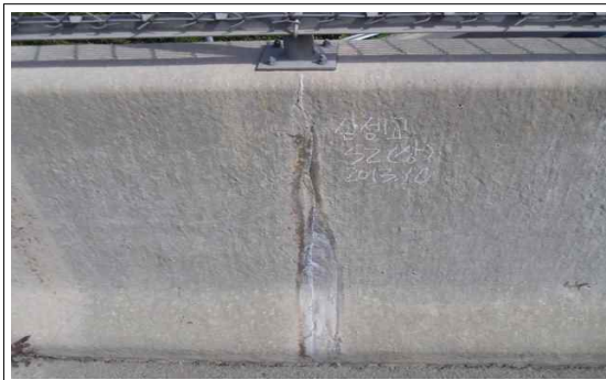
방호벽 상행선 S2 수직균열(CW=0.1mm)
