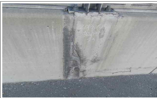
방호벽 상행선 S3 균열부 백태
