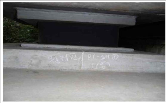
교량받침 상행선 P1 SH10 무수축물탈 균열 (CW=0.1mm)
