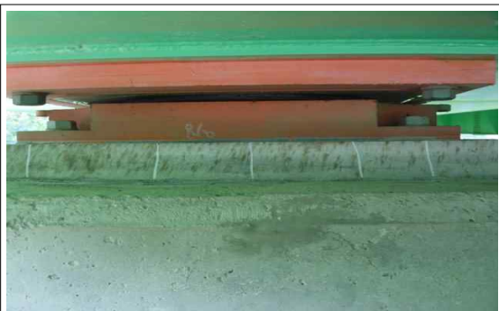
교량받침 하행선 P10 SH1 무수축물탈 균열 (CW=0.1mm)
