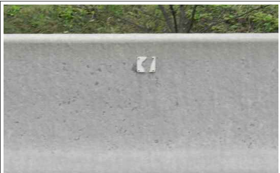
부대시설 상행선 방호벽 S6 텔리네이터 파손
