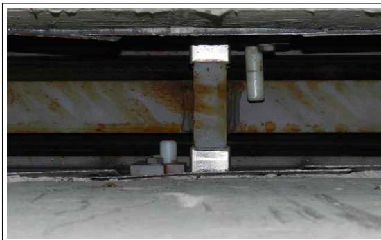
신축이음 상행선 Exp.J3(A2) 유간조절장치 탈락
