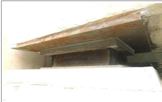
교량받침 하행선 A2 SH1 상부플레이트 녹발생
