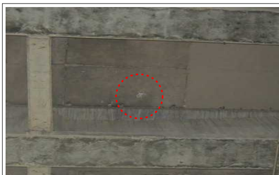
바닥판하면 상행선 S7 백태
