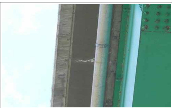
바닥판하면 하행선 S5 균열부 백태
