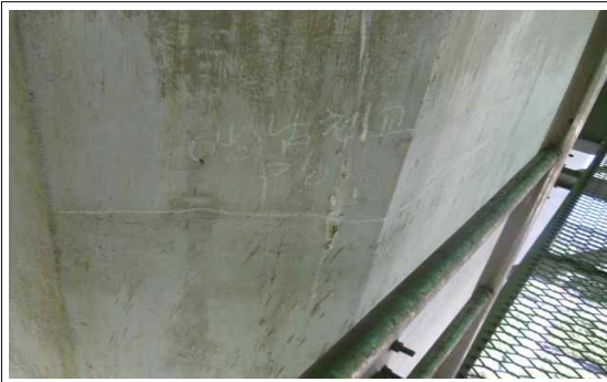
교각 상행선 P6 코핑부 수평균열(CW=0.1mm)
