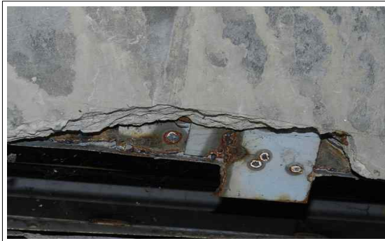
바닥판하면 하행선 S7(A2) 콘크리트 파손
