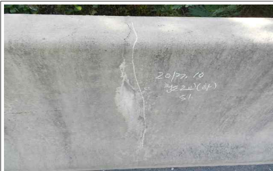
방호벽 하행선 S1 수직균열(CW=0.1mm)
