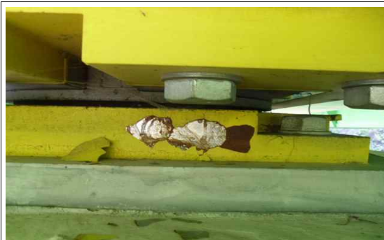
교량받침 상행선 P17 SH1 하부플레이트 녹발생
