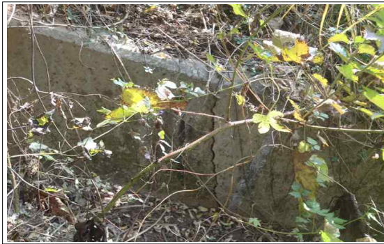
사면(시점부-정면) STA.58+ 10 산마루측구 균열
