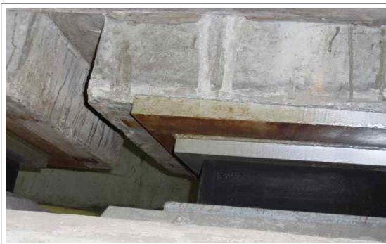
교량받침 상행선 P4 SH6 상부플레이트 녹발생
