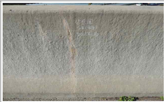
방호벽 하행선 S3 수직균열(CW=0.1mm)
