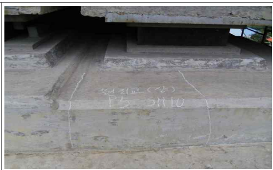
교량받침 상행선 P5 SH10 무수축물탈 균열 (CW=0.1mm)
