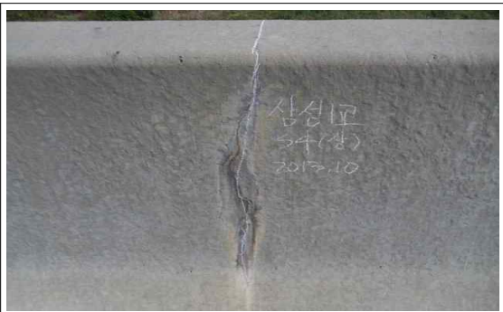
방호벽 상행선 S4 수직균열(CW=0.1mm)
