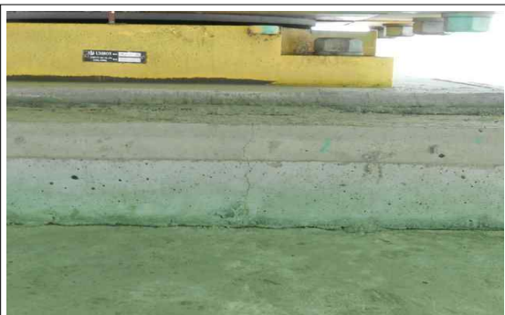
교량받침 상행선 P6 SH1 받침콘크리트 균열 (CW=0.1mm)
