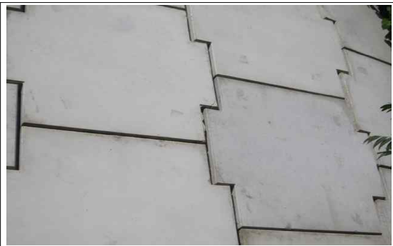
보강토 조립식 옹벽 S11 판넬 파손 (A=0.1X0.1)
