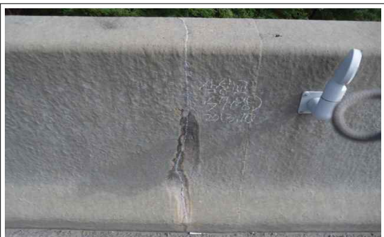
방호벽 상행선 S7 수직균열(CW=0.1mm)
