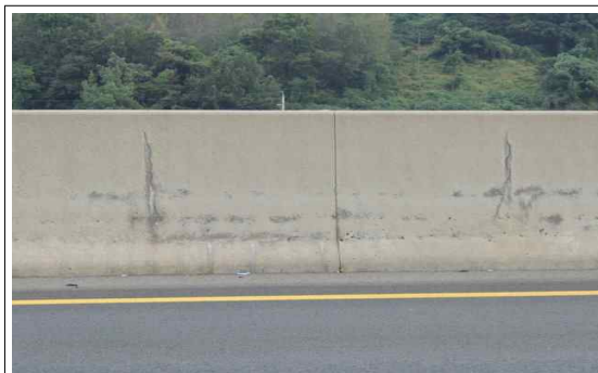
중분대 하행선 S2 균열부 백태
