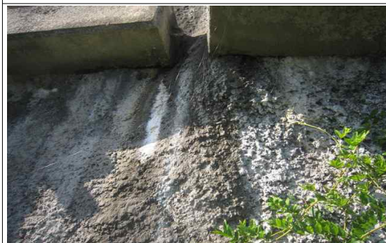
2단 솟크리트 균열 및 백태 (70.80K 지점)
