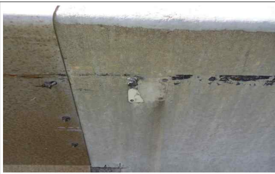
부대시설 하행선 방호벽 S12 텔리네이터 파손
