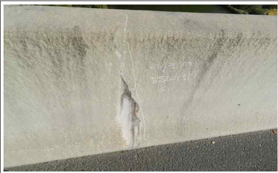
방호벽 상행선 S11 균열부 백태
