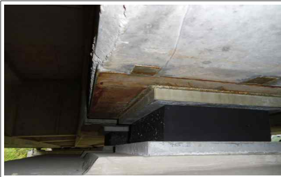
교량받침 상행선 P6 SH3 상부플레이트 녹발생
