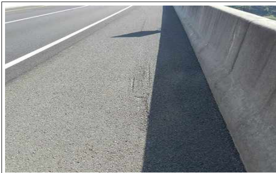
교면포장 하행선 S11 아스콘 패임
