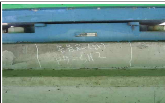
교량받침 하행선 P5 SH2 무수축물탈 균열 (CW=0.1mm)
