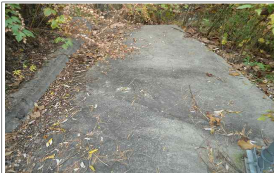
사면(중점부-우측) STA.60+ 270 1소단배수로 균열
