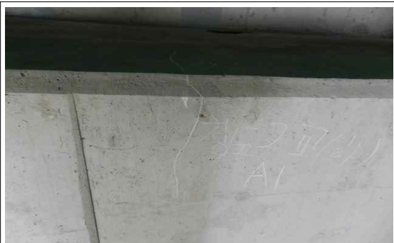
교대 하행선 A1 구체 균열(CW=0.1mm)
