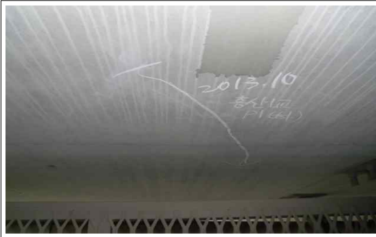
교각 상행선 P1 코핑부 수직균열(CW=0.2mm)
