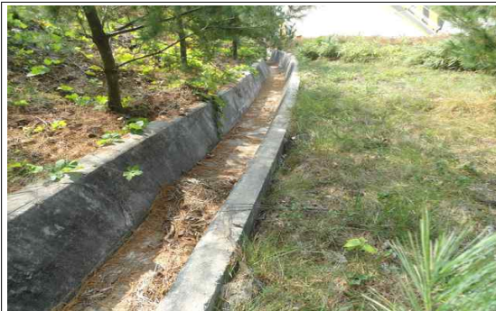
사면(시점부-우측) STA.58+ 640 산마루측구 토사유실
