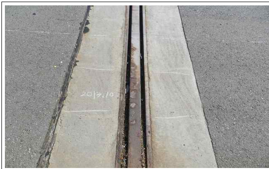
신축이음 하행선 Exp.J2(P3) 후타재 균열 (CW=0.3mm)
