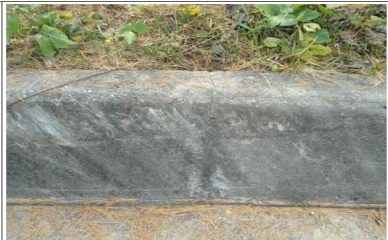
사면(시점부-우측) STA.58+ 650 산마루측구 균열
