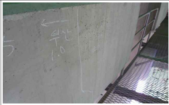
교각 하행선 P15 코핑부 수직균열(CW=0.1mm)
