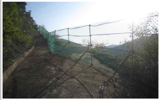
낙석방지울타리로 설치로 인한 3소단배수로 접근불가
