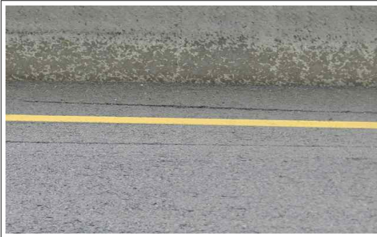
교면포장 상행선 S1 아스콘 패임
