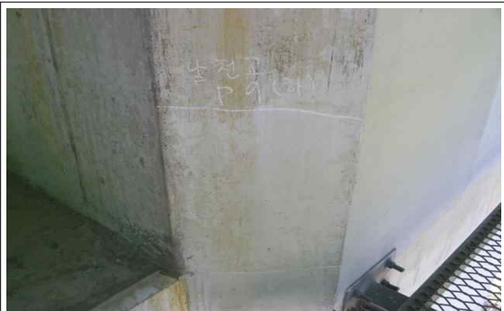
교각 하행선 P9코핑부 수평균열(CW=0.1mm)
