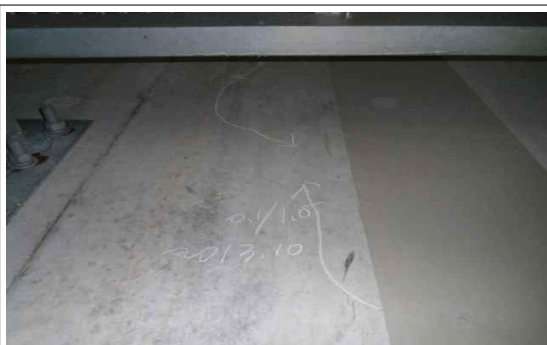
교대 하행선 A1 구체 수직균열(CW=0.1mm)
