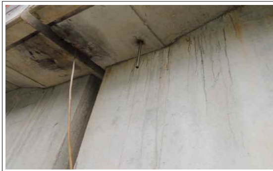
배수시설 하행선 S3(P3) 유도배수관 길이부족
