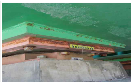
교량받침 하행선 P3 SH3 상부플레이트 녹발생
