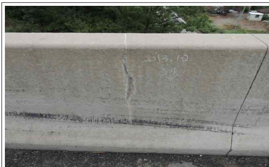
방호벽 상행선 S8 균열부 백태
