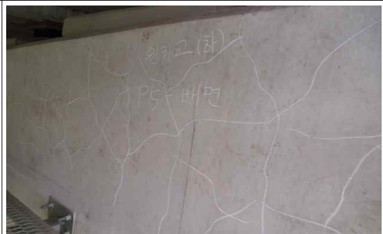
교각 하행선 P5 코핑부 망상균열
