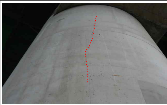
교각 하행선 P3 기둥부 수직균열(CW=0.3mm)
