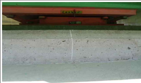
교량받침 하행선 P3 SH1 받침콘크리트 균열 (CW=0.1mm)
