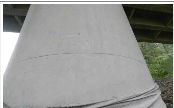
교각 상행선 P3 기둥부 망상균열
