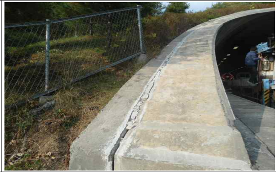
하행선 갭문 시점부 이격 및 파손
