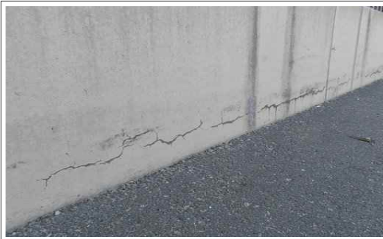
방호벽 상행선 S5 수평균열(CW=0.1mm)
