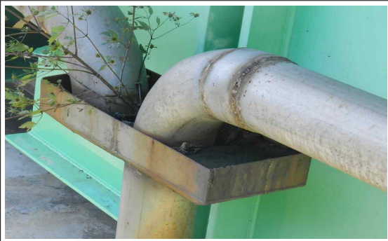
배수시설 상행선 S12 물받이홈통 토사퇴적
