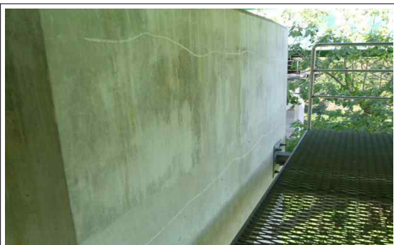
교각 하행선 P10 코핑부 수평균열(CW=0.2mm)
