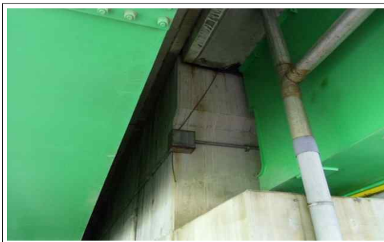
배수시설 하행선 S1(A1) 유도배수관 길이부족
