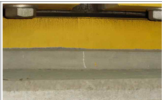
교량받침 하행선 P1 SH2 무수축물탈 균열 (CW=0.1mm)
