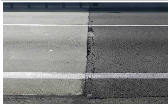
교면포장 상행선 S1(A1) 접속부 파손
