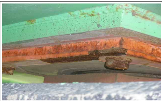
교량받침 상행선 P7 SH 상부플레이트 녹발생
