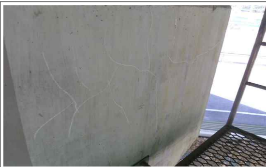
교각 하행선 P1 코핑부 망상균열
