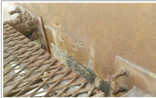
교각 상행선 P4 코핑부 콘크리트 박락
