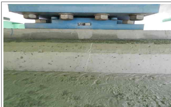
교량받침 상행선 P9 SH1 받침콘크리트 균열 (CW=0.1mm)
