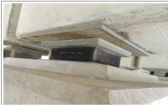
교량받침 하행선 P3 SH2 상부플레이트 녹발생
