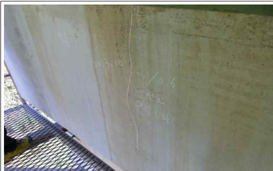
교각 하행선 P7 코핑부 수직균열(CW=0.1mm)
