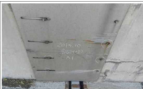
부대시설 상행선 Exp.J1(A1) 차수관 볼트변형 및 탈락
