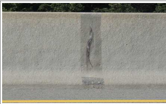
방호벽 상행선 S7 균열부 백태
