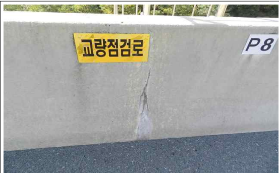
방호벽 하행선 S3 균열부 백태
