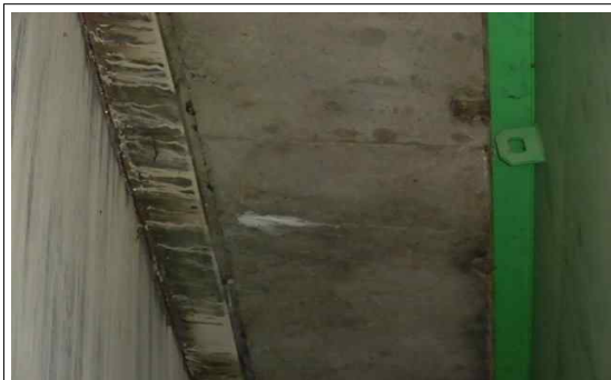
바닥판하면 상행선 S3 균열부 백태
