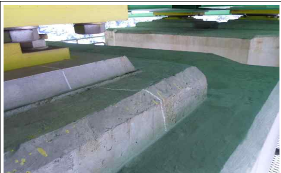
교량받침 하행선 P7 SH2 받침콘크리트 균열 (CW=0.1mm)
