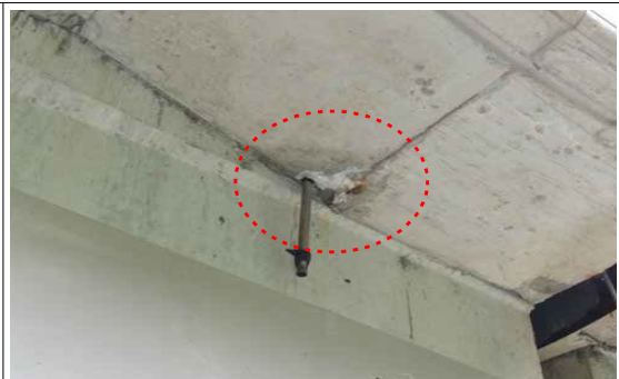
바닥판하면 상행선 S3 백태
