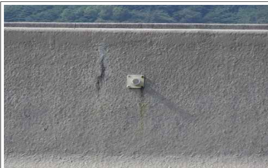
부대시설 상행선 중분대 S7 텔리네이터 파손
