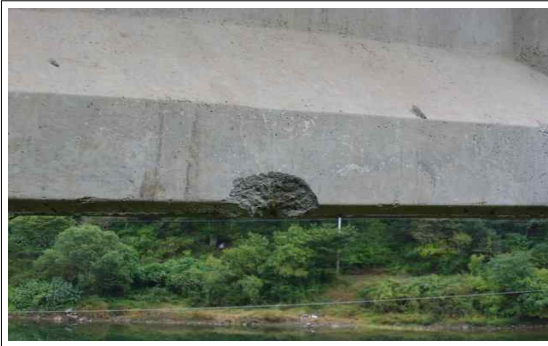
주형 상행선 S8 G1 우측면 콘크리트 파손
