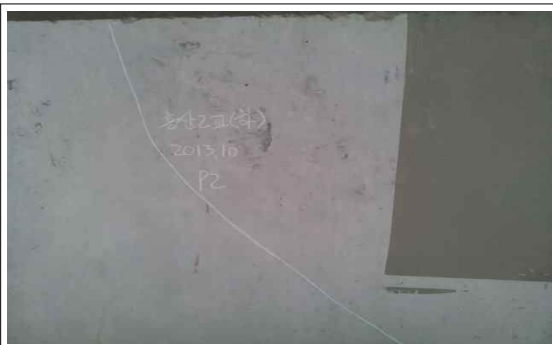
교각 하행선 P2 코핑부 경사균열(CW=0.1mm)
