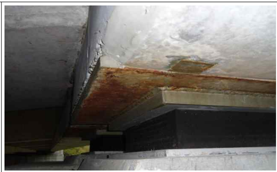
교량받침 하행선 P1 SH6 상부플레이트 녹발생
