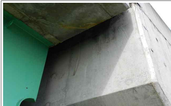
배수시설 상행선 S11(A2) 유도배수관 길이부족
