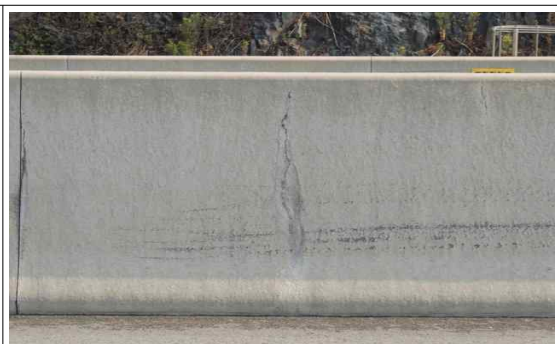
중분대 하행선 S2 균열부 백태
