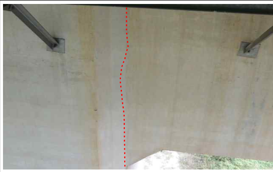
교각 하행선 P11 코핑부 수직균열(CW=0.1mm)
