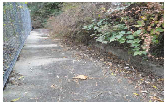
사면(중점부-우측) STA.60+ 270 1소단배수로 체수흔적
