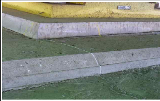
교량받침 상행선 P1 SH1 받침콘크리트 균열 (CW=0.1mm)
