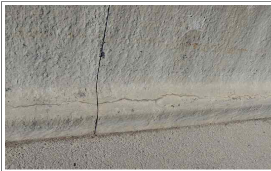
방호벽 하행선 S1 수평균열(CW=0.1mm)
