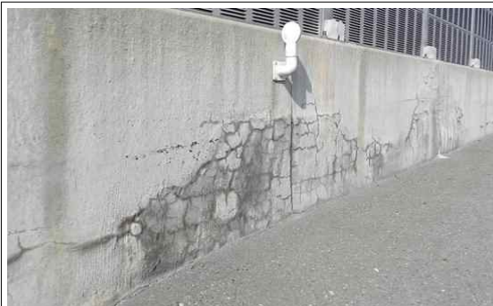
방호벽 하행선 S4 망상균열 및 백태
