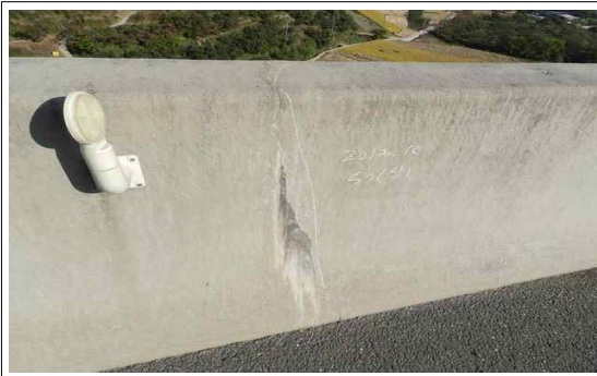
방호벽 상행선 S7 균열부 백태
