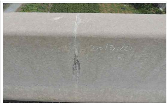
방호벽 상행선 S7 수직균열(CW=0.1mm)
