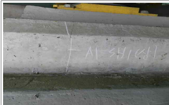
교량받침 하행선 A1 SH1 받침콘크리트 균열 (CW=0.1mm)
