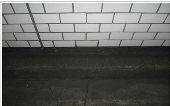
상행선 공동구 S97 균열
