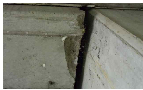
바닥판하면 상행선 S1(A1) 콘크리트 파손
