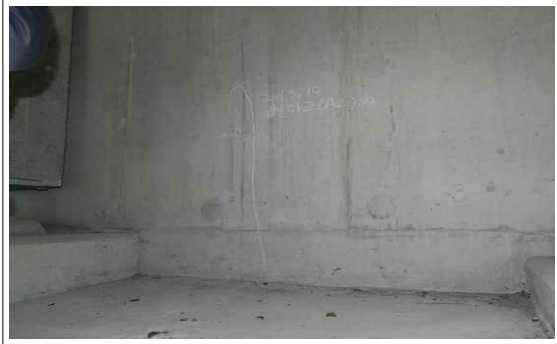
교대 상행선 A2 흉벽 수직균열(CW=0.1mm)
