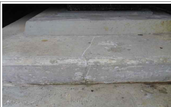
교량받침 상행선 A2 SH5 받침콘크리트 균열 (CW=0.1mm)
