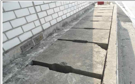
상행선 공동구 S1 덮개파손
