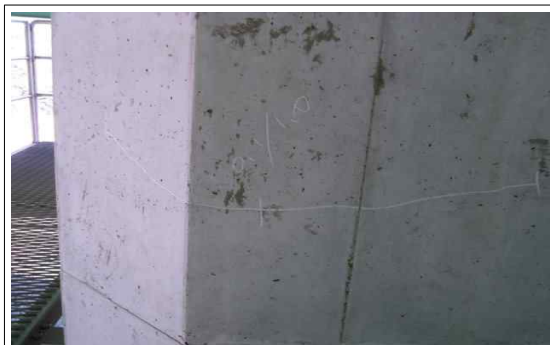
교각 하행선 P2 기둥부 수평균열(CW=0.1mm)
