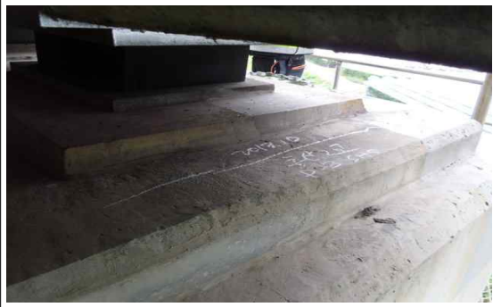
교량받침 상행선 P3 SH5 받침콘크리트 균열 (CW=0.1mm)
