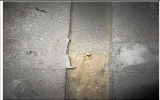
공동구내부 B면 바닥부 누수 (STA.0+30)
