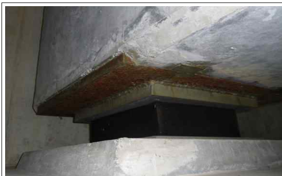
교량받침 상행선 A1 SH2 상부플레이트 녹발생
