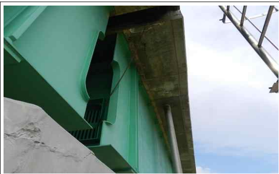
배수시설 상행선 S8(P7) 유도배수관 길이부족
