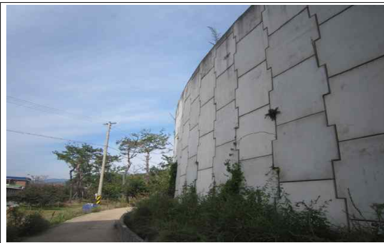
보강토 조립식 옹벽 S8 배부름
