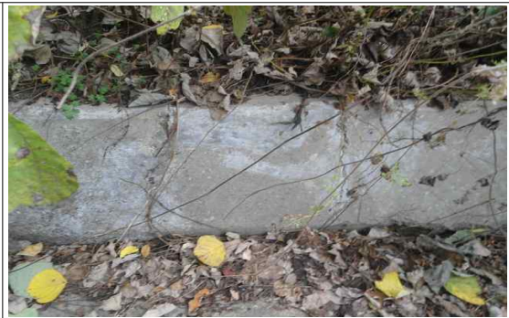
사면(중점부-정면) STA.0-30 산마루측구 균열
