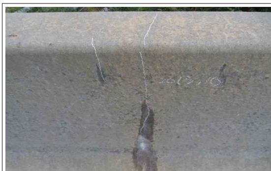
방호벽 상행선 S1 균열부 백태
