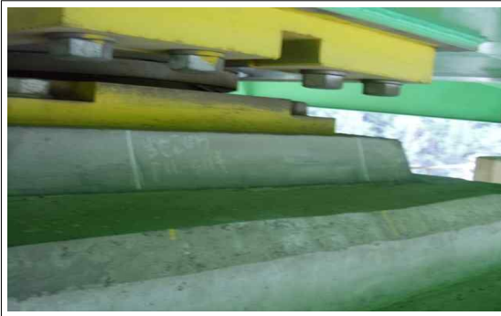
교량받침 하행선 P11 SH4 무수축물탈 균열 (CW=0.1mm)
