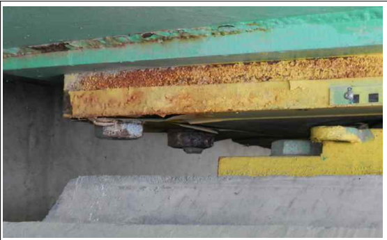
교량받침 상행선 A1 SH1 플레이트 볼트 녹발생
