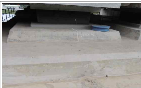
교량받침 하행선 P1 SH6 무수축물탈 균열 (CW=0.1mm)
