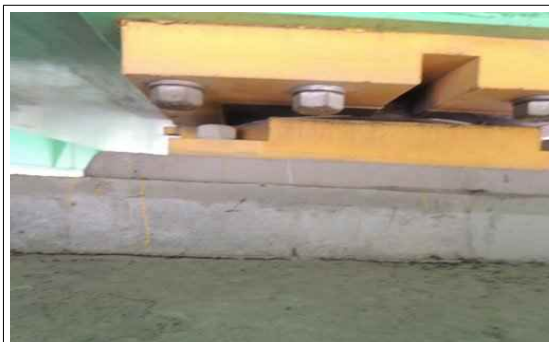
교량받침 상행선 P1 SH1 무수축물탈 균열 (CW=0.1mm)
