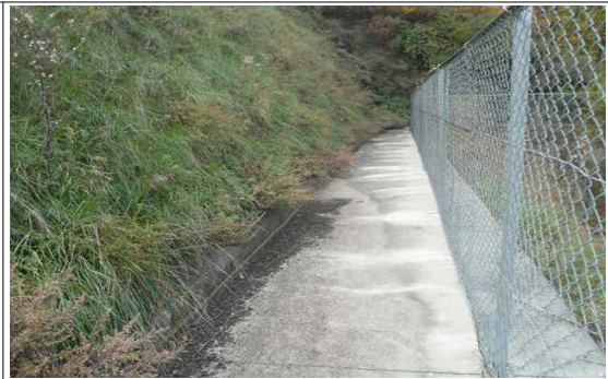
사면(중점부-정면) STA.0+ 30 1소단배수로 체수흔적
