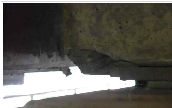
주형 상행선 S3 G2 플레이트 매립부 파손
