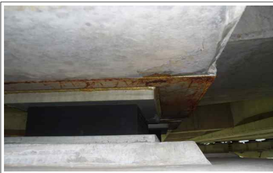
교량받침 상행선 P7 SH9 상부플레이트 녹발생
