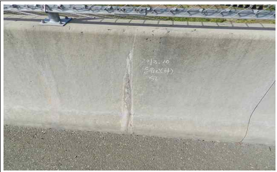
방호벽 하행선 S2 수직균열(CW=0.1mm)
