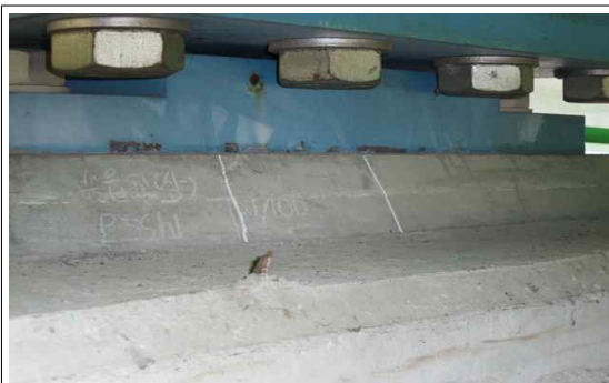
교량받침 상행선 P5 SH1 무수축물탈 균열 (CW=0.1mm)
