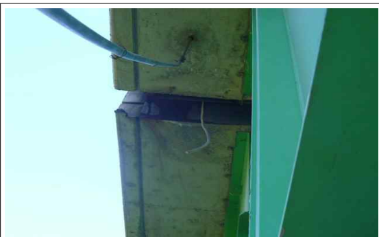
배수시설 하행선 S3(P3) 유도배수관 길이부족
