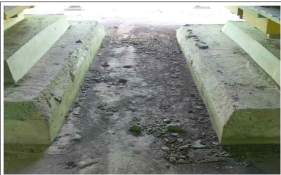
교각 하행선 P4 코핑부 콘크리트 박리, 박락
