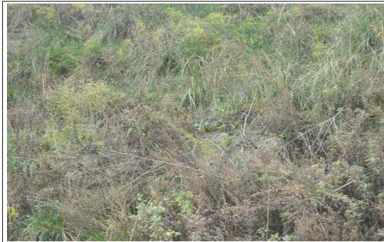
사면(중점부-정면) STA.0+ 0 2단 녹생토유실
