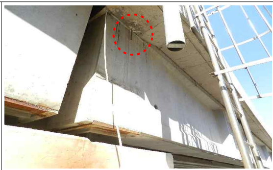
배수시설 상행선 S4(P3) 유도배수관 길이부족
