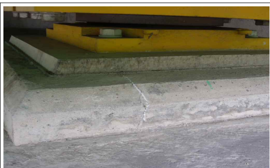
교량받침 하행선 A2 SH2 받침콘크리트 균열 (CW=0.1mm)
