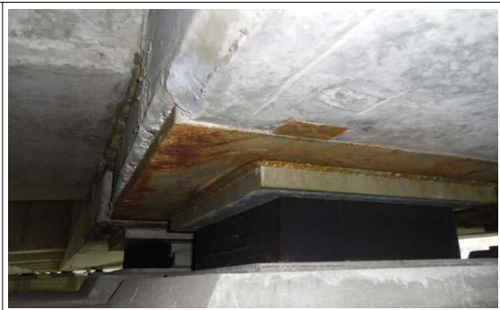
교량받침 하행선 P7 SH8 상부플레이트 녹발생
