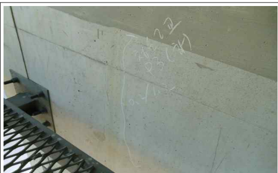
교각 하행선 P3 코핑부 수직균열(CW=0.2mm)
