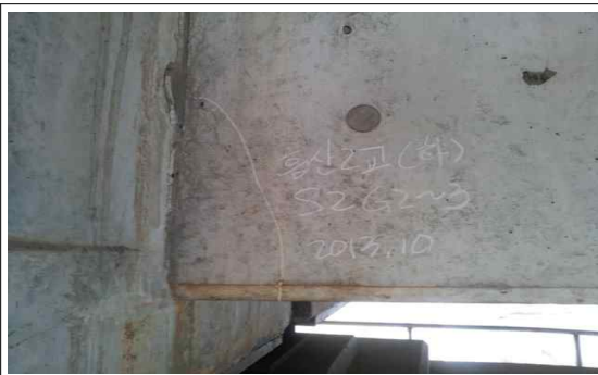
가로보 하행선 S2 G2~G3 콘크리트 들뜸
