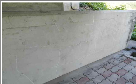
교대 상행선 A2 구체 망상균열
