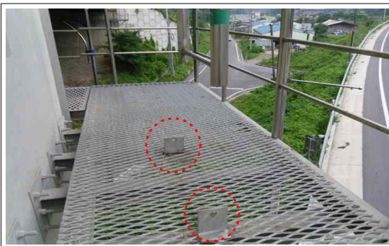
부대시설 하행선 P1 점검사다리 파손
