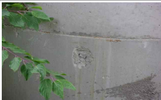
교각 하행선 P4 기둥부 콘크리트 파손
