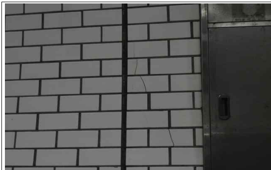
하상행선 측벽부 S77 타일균열
