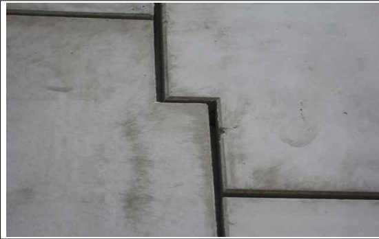
보강토 조립식 옹벽 S2 판넬 파손 (A=0.1X0.1)
