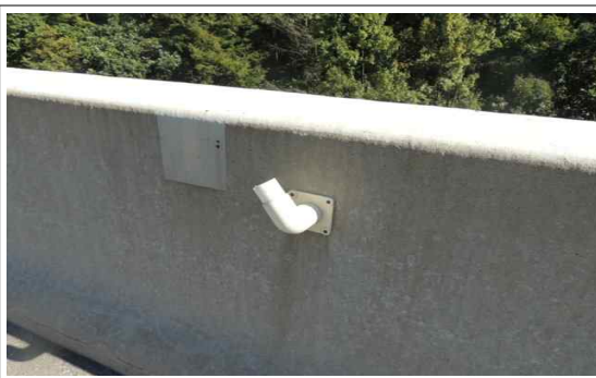
부대시설 상행선 방호벽 S14 텔리네이터 파손
