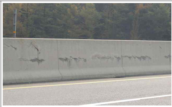
중분대 하행선 S7 균열부 백태
