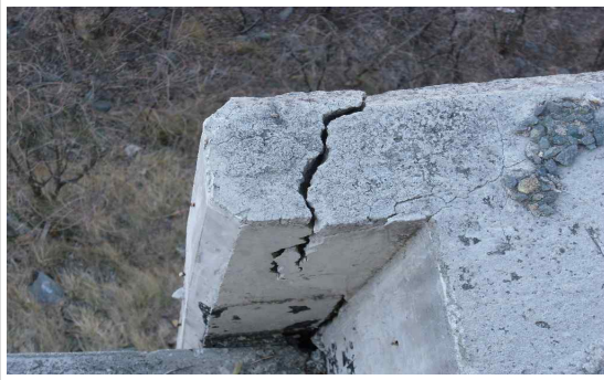
교대 하행선 A1 우측 날개벽 콘크리트 파손
