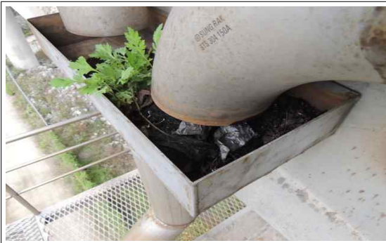
배수시설 상행선 S6(P6) 물받이홈통 내부 이물질퇴적
