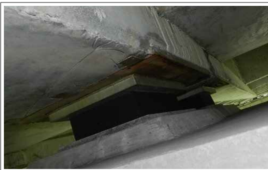
교량받침 상행선 P1 SH3 상부플레이트 녹발생
