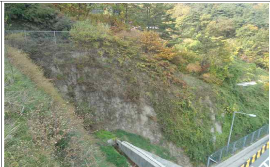
사면(중점부-우측) STA.60+ 290 1단 녹생토유실
