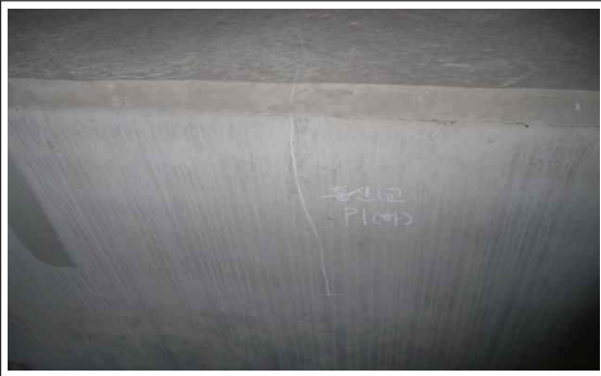
교각 하행선 P1 코핑부 수직균열(CW=0.2mm)
