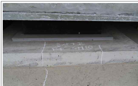
교량받침 상행선 P4 SH10 무수축물탈 균열 (CW=0.1mm)
