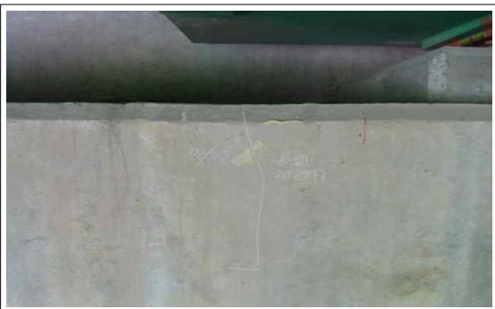
교대 하행선 A1 구체 수직균열(CW=0.1mm)
