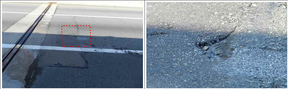
교면포장 상행선 S1 아스콘 보수부 재패임
