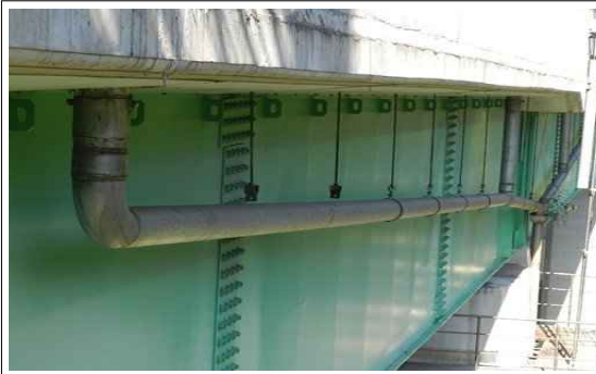
배수시설 상행선 S12 배수관 고정고리 탈락
