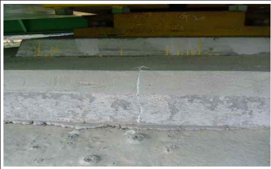
교량받침 상행선 P2 SH2 받침콘크리트 균열 (CW=0.1mm)
