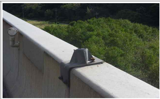
부대시설 하행선 방호벽 S17 표지판 파손
