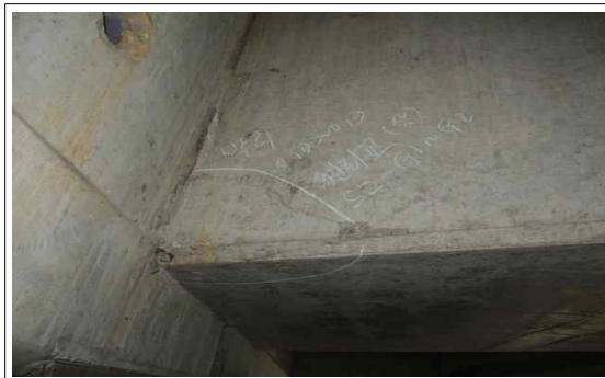
가로보 상행선 S2 G1~G2 콘크리트 들뜸
