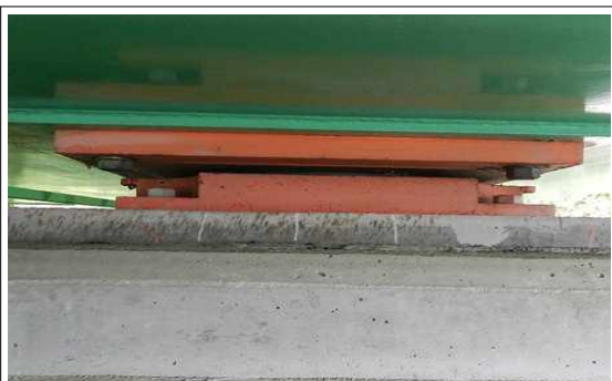
교량받침 상행선 P10 SH2 무수축물탈 균열 (CW=0.1mm)
