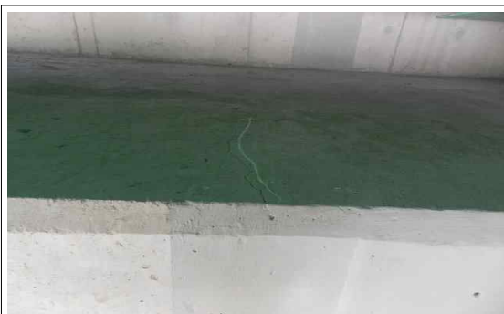
교대 상행선 A1 구체 균열(CW=0.2mm)
