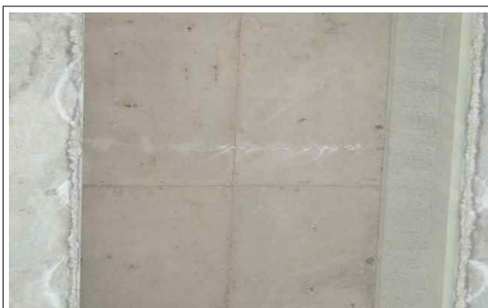
바닥판하면 하행선 S2 균열부 백태
