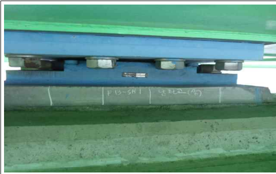
교량받침 상행선 P13 SH1 무수축물탈 균열 (CW=0.1mm)
