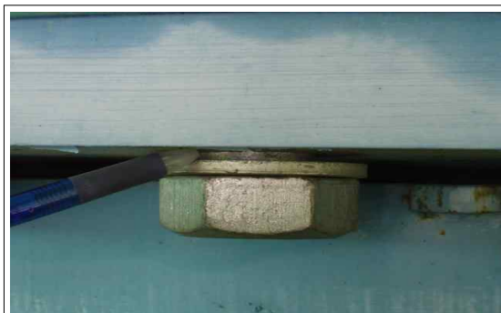
교량받침 하행선 P2 SH2 플레이트 볼트 이완
