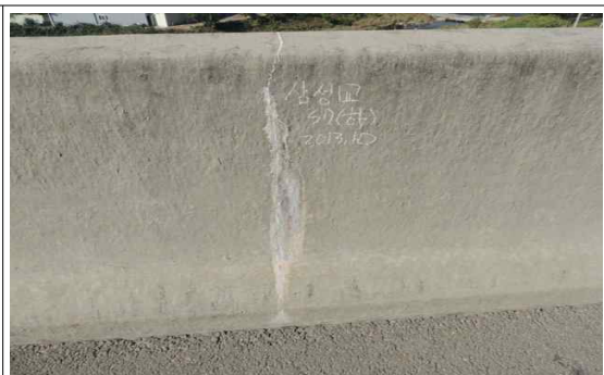
방호벽 하행선 S7 균열부 백태
