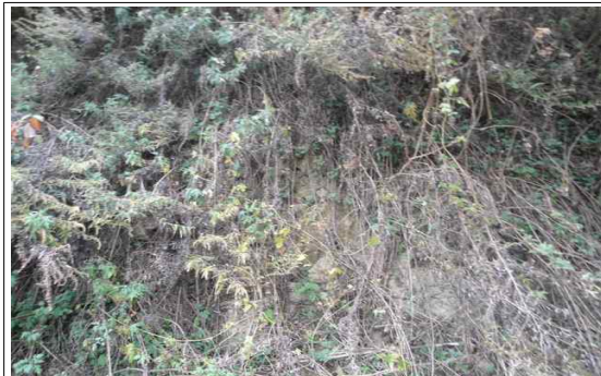
사면(중점부-우측) STA.60+ 270 2단 녹생토유실
