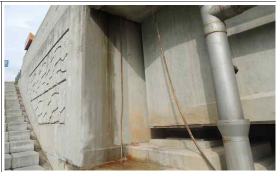
배수시설 하행선 S5(A2) 유도배수관 길이부족
