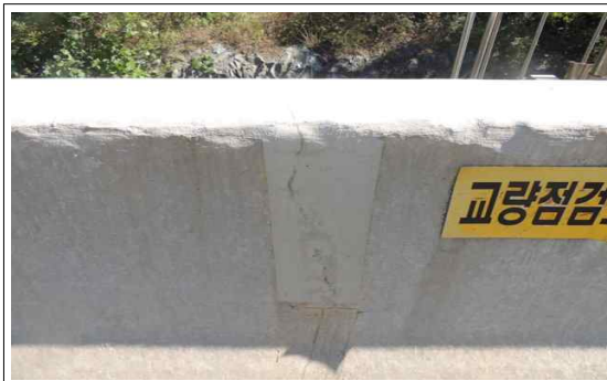
방호벽 상행선 S18 보수부 재균열 (CW=0.1mm)
