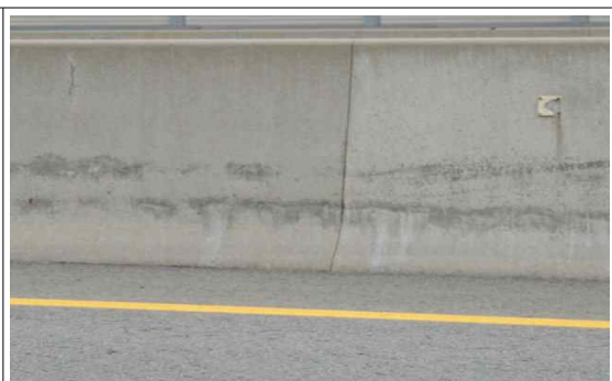
중분대 상행선 S4 균열부 백태
