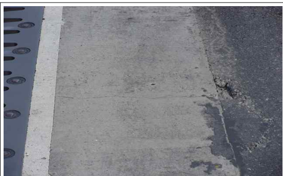
신축이음 상행선 Exp.J3(P7) 후타재 균열 (CW=0.2mm)
