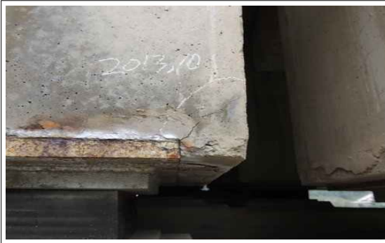
주형 하행선 S6 G6 플레이트매립부 콘크리트 파손
